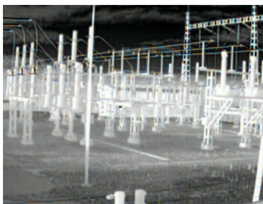
La stessa scena ripresa da una telecamera termica Axis utilizzando una palette B/N.
